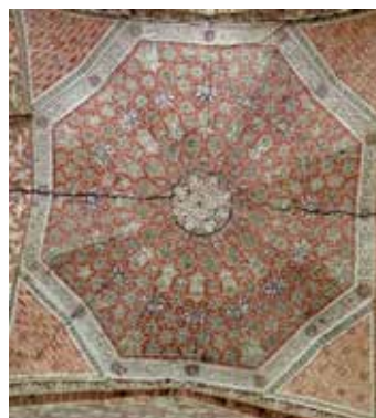
تصویر ۴: گچ‌بری و رنگ آمیزی، ایوان شمال شرقی، گنبد سلطانیه، ۷۰۴-۷۱۲ ه. ق. (ماخذ: نگارندگان).
